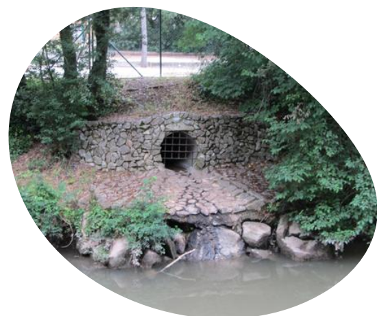
Rejet direct du pluvial dans un cours d'eau
